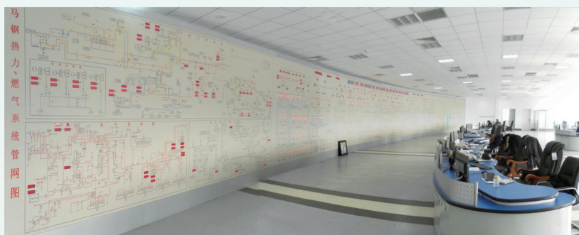
现代化能源控制中心
